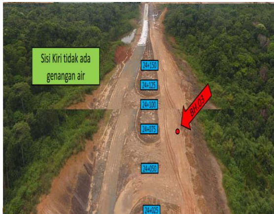
Gambar 2 Lokasi Tinjauan Longsor Sta.24+100
